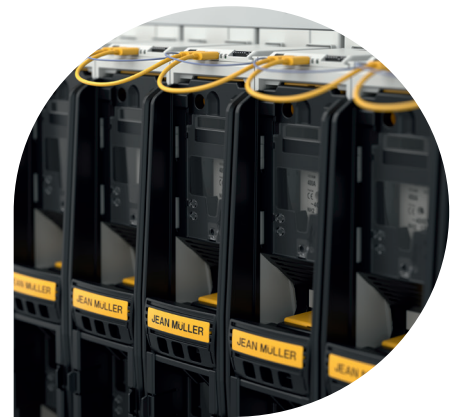
Vollständige und effiziente Erfassung aller Energie- daten in der Niederspannungs-Hauptverteilung Complete and efficient capture of all energy data in the low-voltage main distribution
